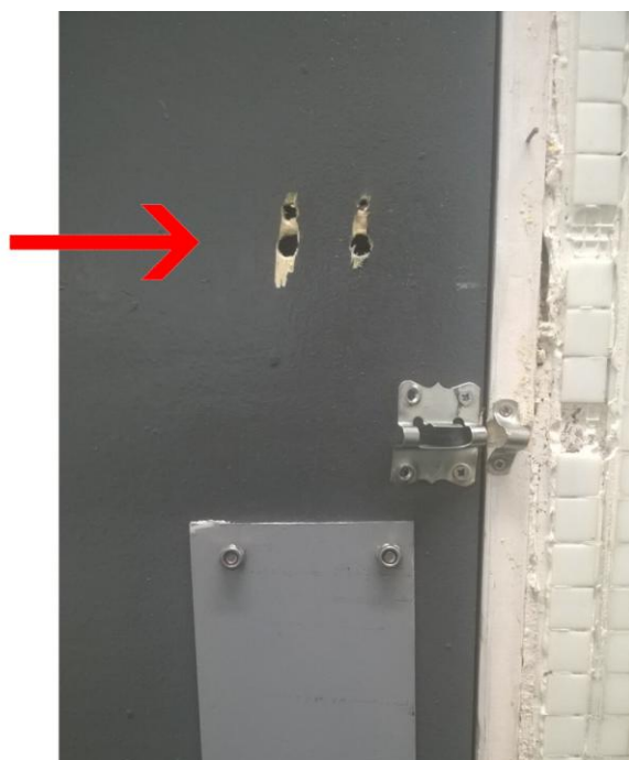
Figura 8 – Dois buracos na porta do banheiro da Estação de metrô Maracanã. Fonte: Autor, 2017.
